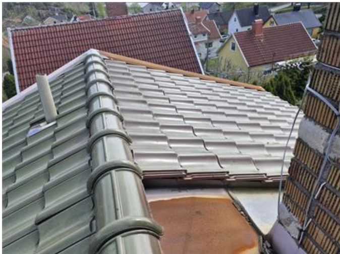
Tak, översiktsbild med rostangrepp på plåtarebeten.
