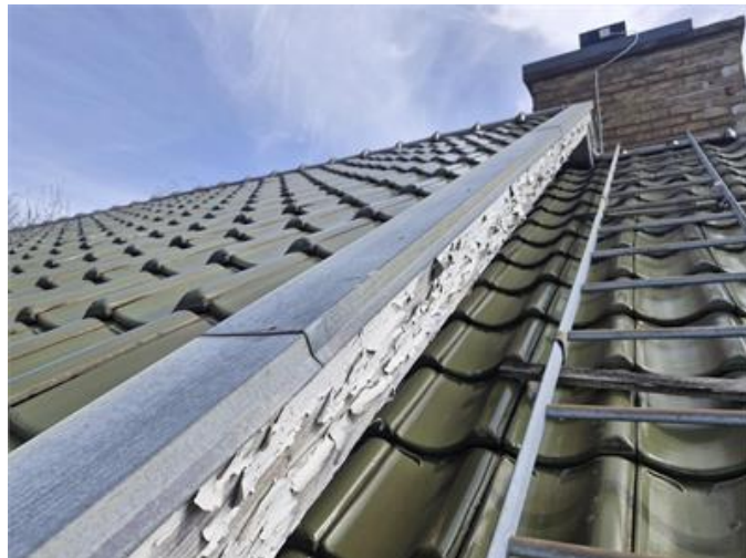
Tak, vindskivor med kraftigt färgsläpp.
