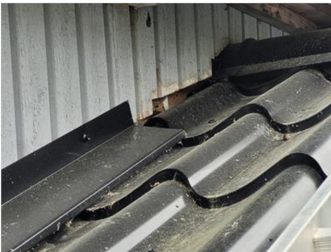
Anslutningsplåt mellan takdelar och fasad är ej infräst bakom panel samt saknas delvis.
