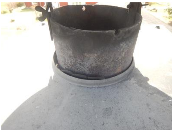
Tätning mellan skorsten och skorstenshuv som är otät.
