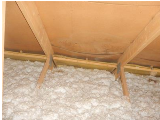
Fuktfläckar på underlagstak vind.
