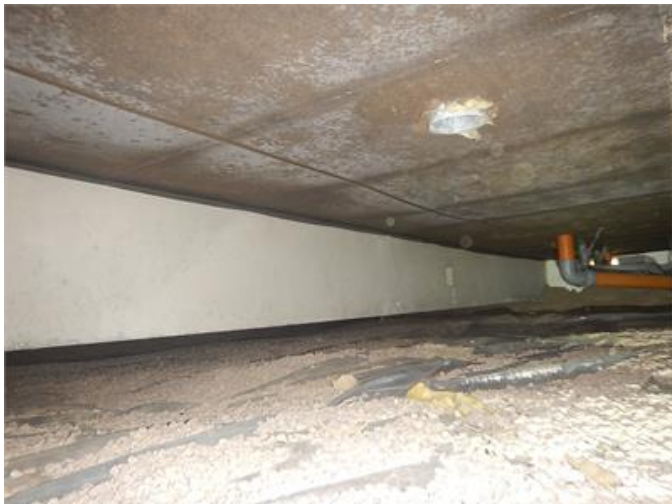
Mikrobiell påväxt och kaminens tilluft krypgrund.
