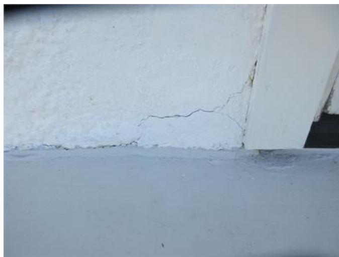
Spricka/putssläpp i fasaden vid entrédörren
