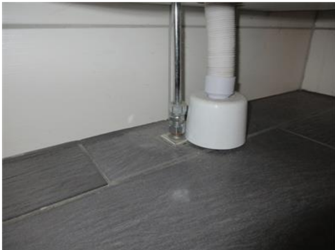
Rör genomföring i våtrumsgolv
