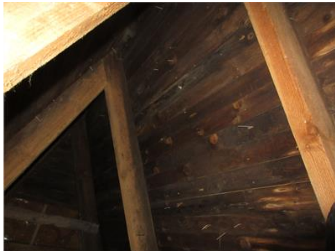
Mikrobiell påväxt på vinden
