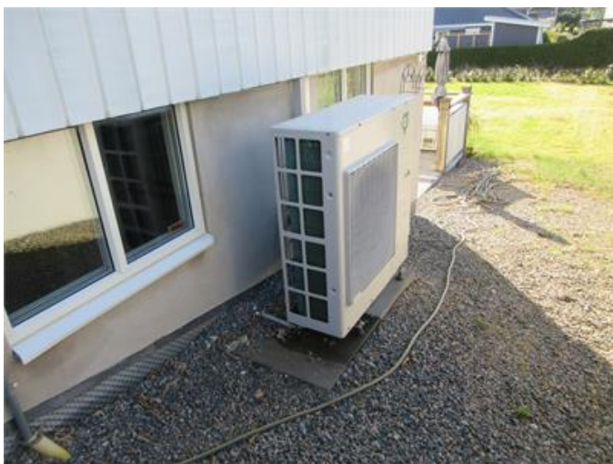
Värmepumpens utomhusdel vid fasaden
