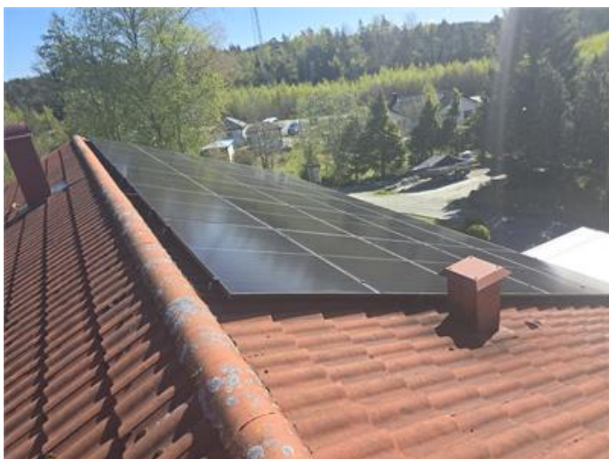
Delar av takpannor ej besiktningsbara pga montage av solcellspaneler.
