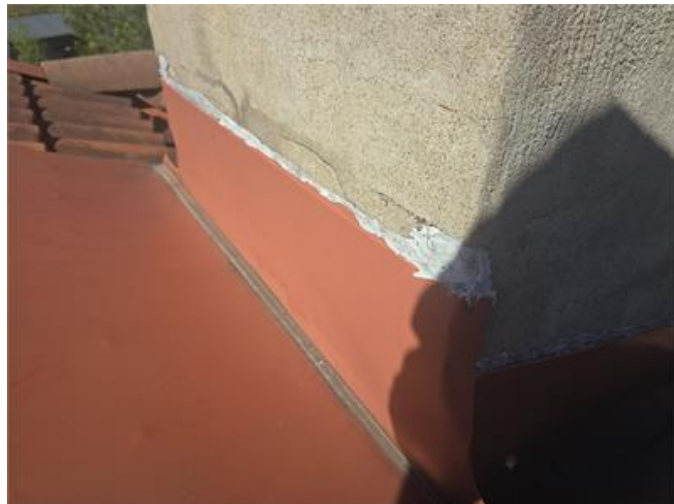
Sprickor i puts på murstockens ovansida.
