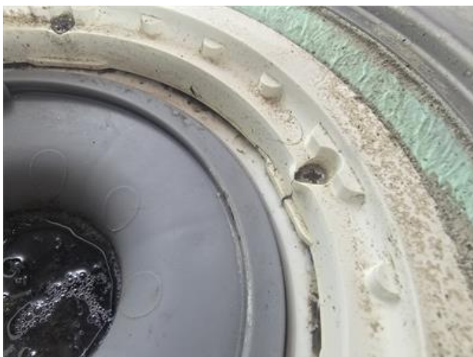
Exempelbild, för hårt åtdragen skruv i klämring.
