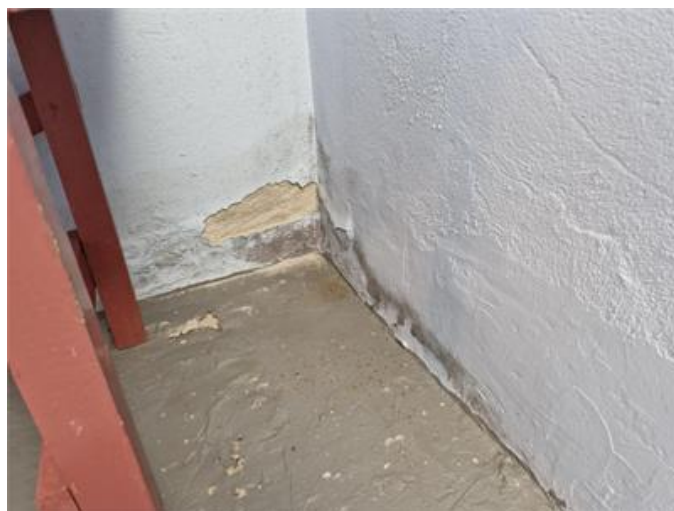
Källare, färgsläpp grutmuren.
