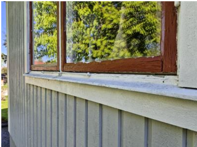
Fönster, äldre med renoveringsbehov alt byte.
