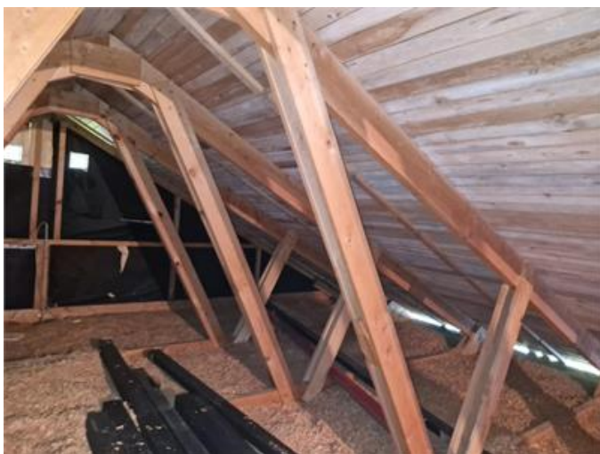
Nockvind, mikrobiell påväxt i underlagstaket.
