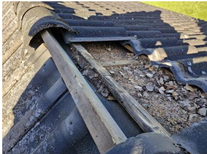
Tak, rikligt med löv under pannorna och uppfuktad läkt.
