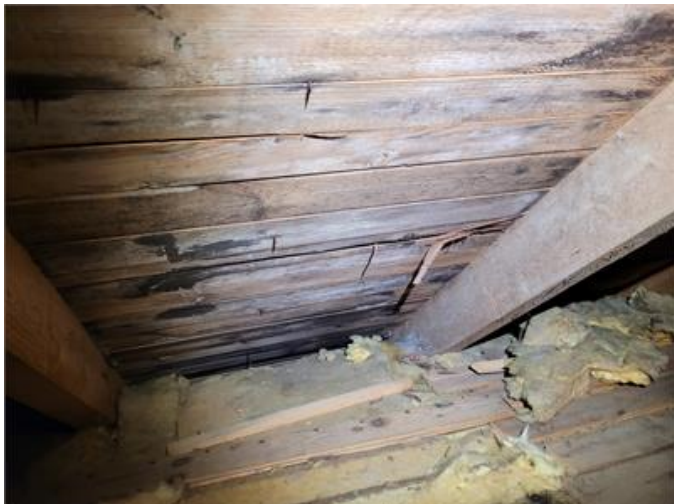
Mikrobiell påväxt på underlagstak.
