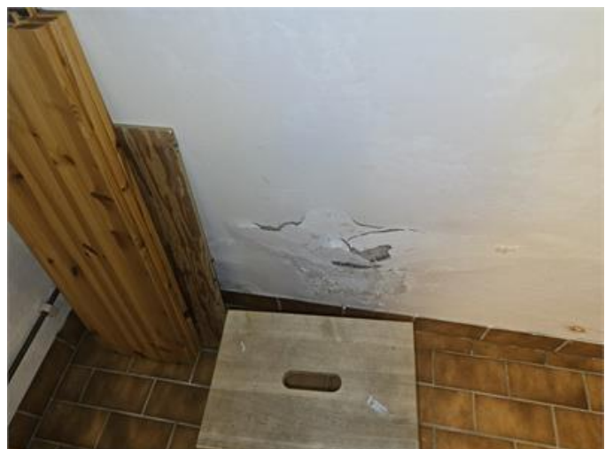
Exempel putssläpp i källare samt salt-/kalkutfällning.
