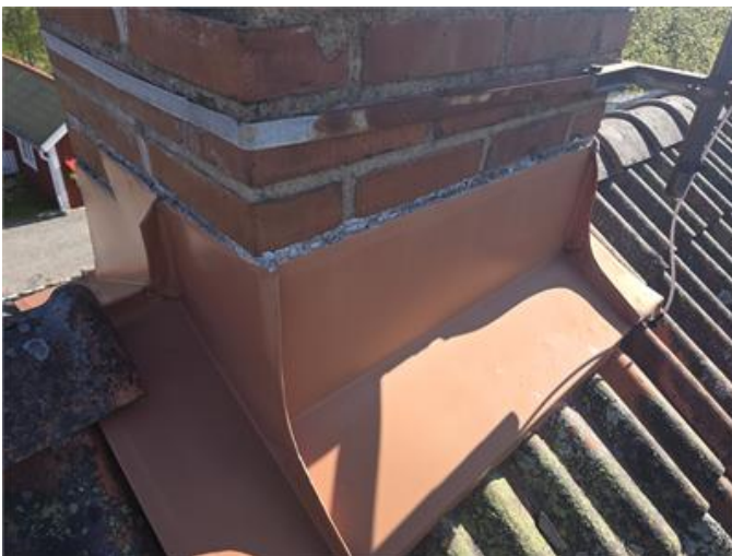
Exempel på torrsprickor i fog mellan plåt och mursten.
