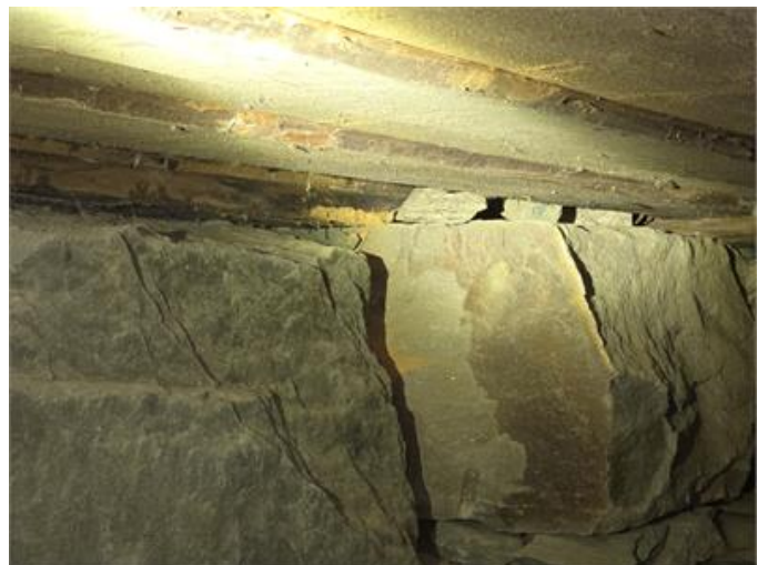
Exempel på torröta i torpargrund, det noteras även spår av träskadeinsekter i utrymmet.
