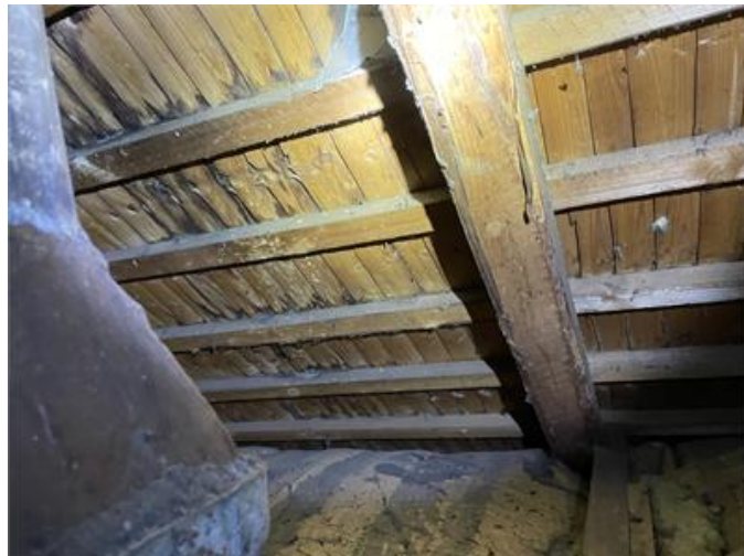
Spår efter lokala inläckage vindsutrymme.
