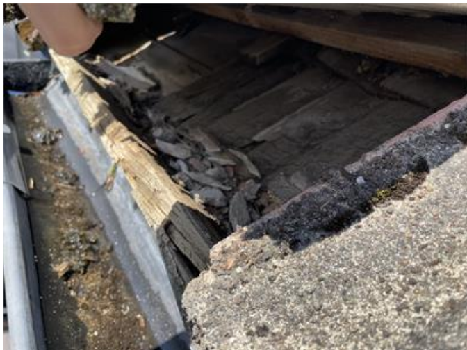
Rötskador i takutsprång under pannor.
