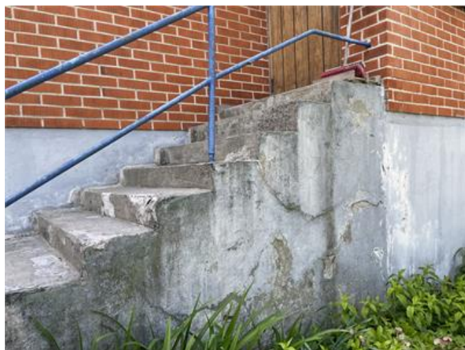
Grundmurar och trappor till entré och källare har underhållsbehov.
