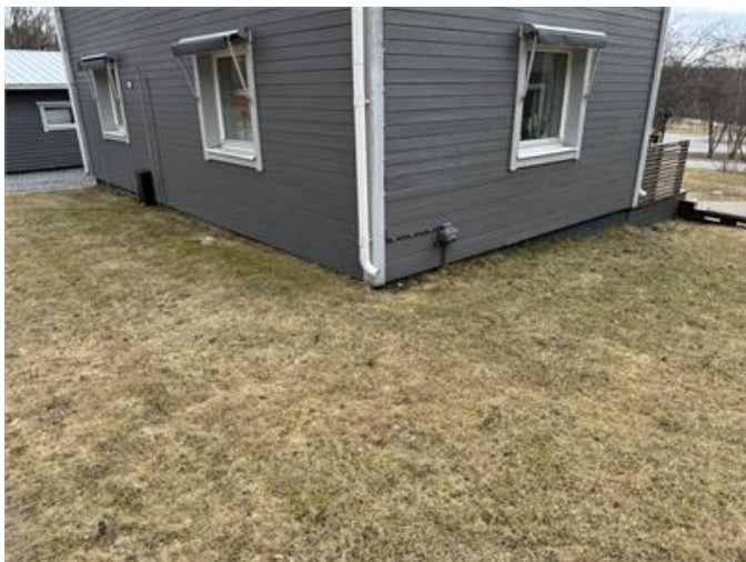
Marken lutar mot huset och sockelhöjden är låg.
