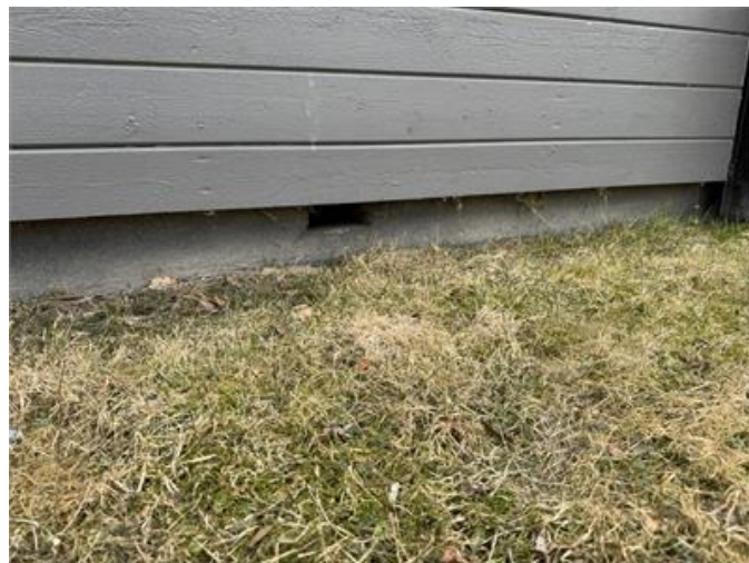
Ventilgaller saknas i grundmur.
