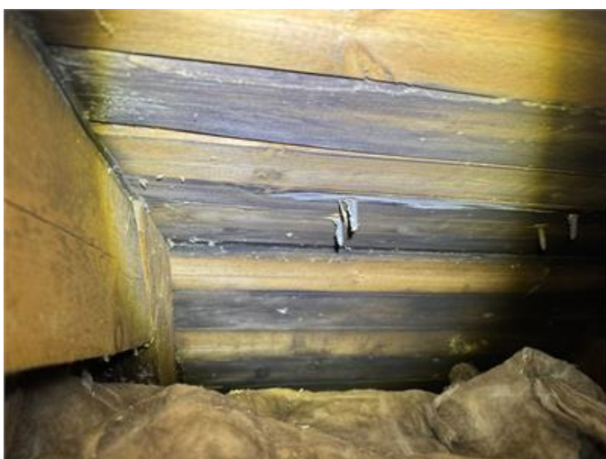
Mikrobiell påväxt på underlagstak i vindsutrymme.
