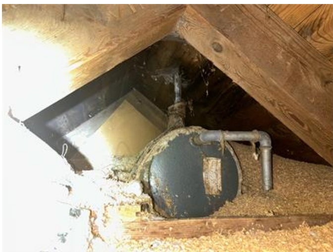
Nockvind, mörk mikrobiell påväxt på underlagstaket.
