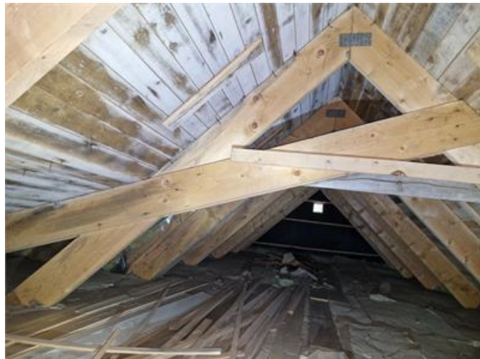
Nockvind, mikrobiell påväxt på underlagstaket sk konvektionskada.
