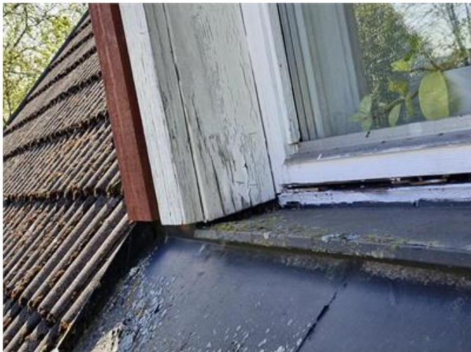
Fasad, exempel foder/smygar med bytesbehov.
