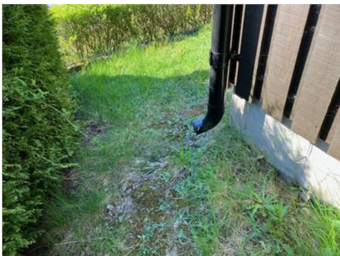
Stuprör på garaget som släpper ut vatten ovan mark
