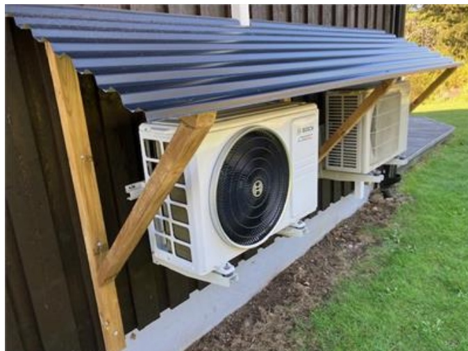
Luftvärmepumparna på fasaden
