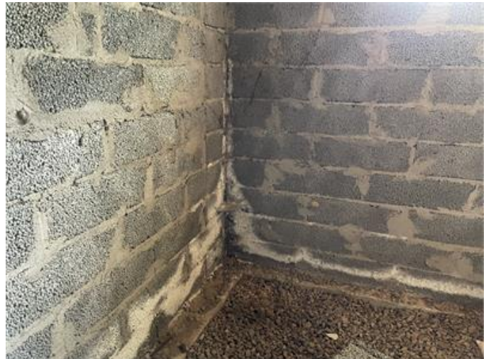
I tillbyggnad är fuktgenomslag något mer påtagligt till hörn och närmst vot vilket kan vara en indikation på brister i stuprörets avledning/dränering vilket rekommenderas att kontrolleras vidare.
