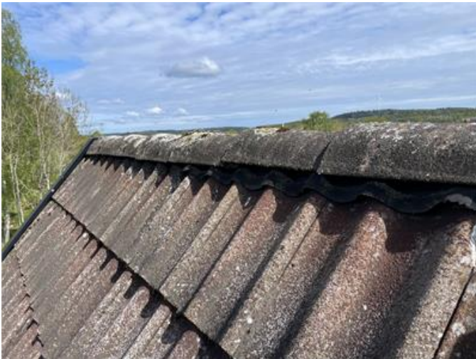
Nocktätning till yttertak är spröd och har förlitningar.
