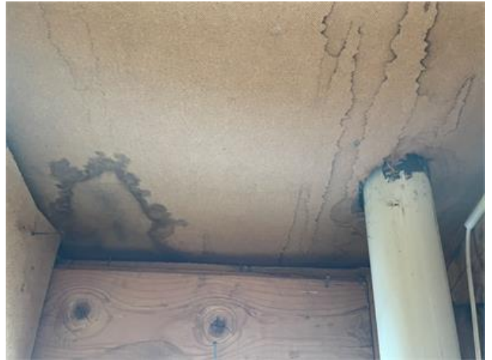
Spår efter fuktinträngning sidovind vilken rekommenderas att kontrolleras. Ingen förhöjd fukt uppmättes vid besiktningen.
