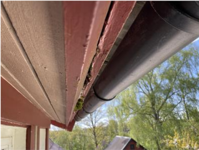
Lokal fuktskada i takfot kupa.
