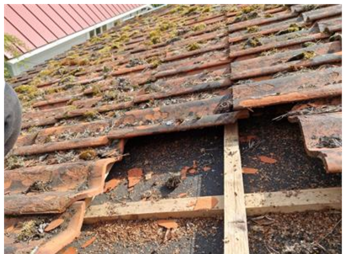
Tak, mossa på pannorna och trasiga/skiktade pannor.
