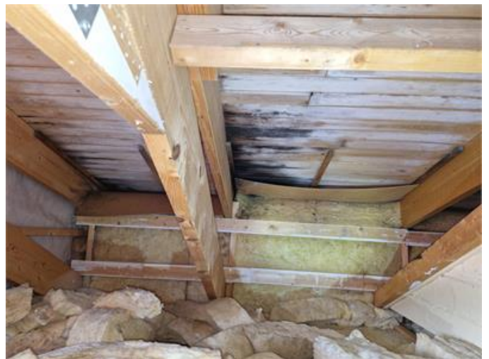
Nockvind, mikrobiell påväxt i underlagstaket utbyggnad, framförallt ovan entren.
