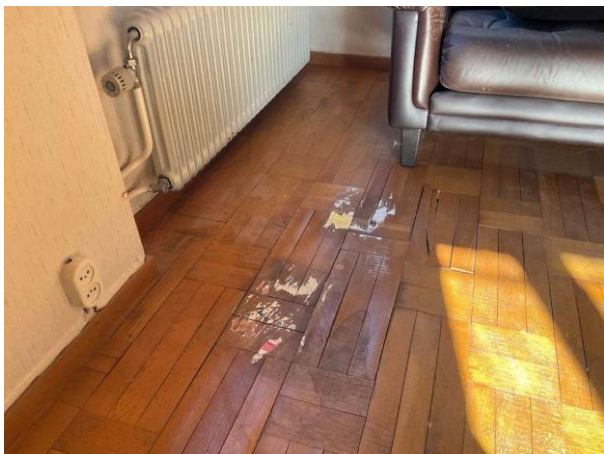
Bild 9: Invändigt, Övervåning, Sovrum 2, Finns skador och missfärgningar på golv.
