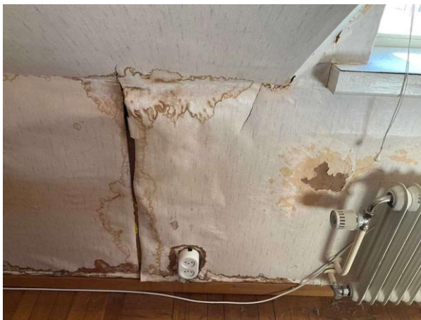
Bild 10: Invändigt, Övervåning, Sovrum 2, På yttervägg vid takkupan finns omfattande missfärgningar/fuktgenomslag.
