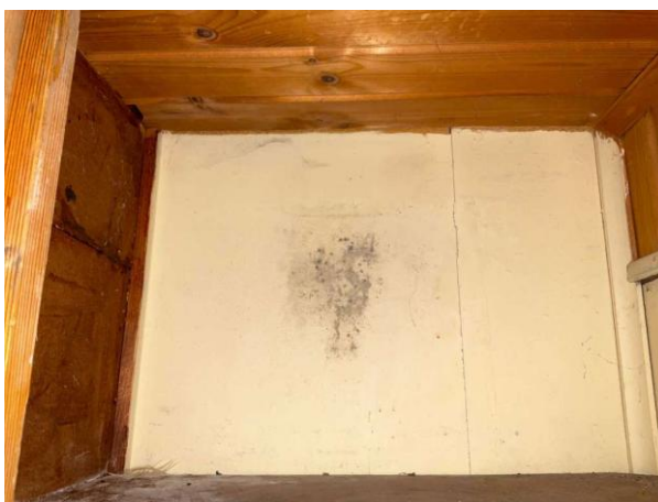
Bild 6: Invändigt, Entréplan, Entré (baksidan), Noterades missfärgningar i garderob.
