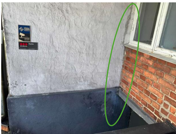
Bild 2: Utvändigt, Fasad, Finns längsgående sprickbildning på både putsad fasad och grundmur och intill entré på baksidan.
