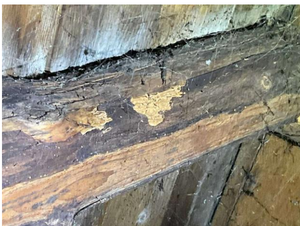
Bild 5: Invändigt, Vind, I utrymmet (på äldre takstolar) noterades träskadedjursangrepp.
