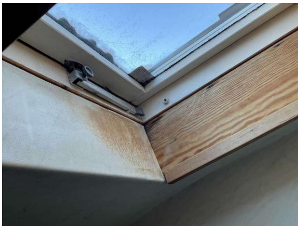
Bild 8: Invändigt, Övervåning, Våtrum, Finns missfärgningar i smyg vid takfönster och viss beläggning/påväxt på glaset.
