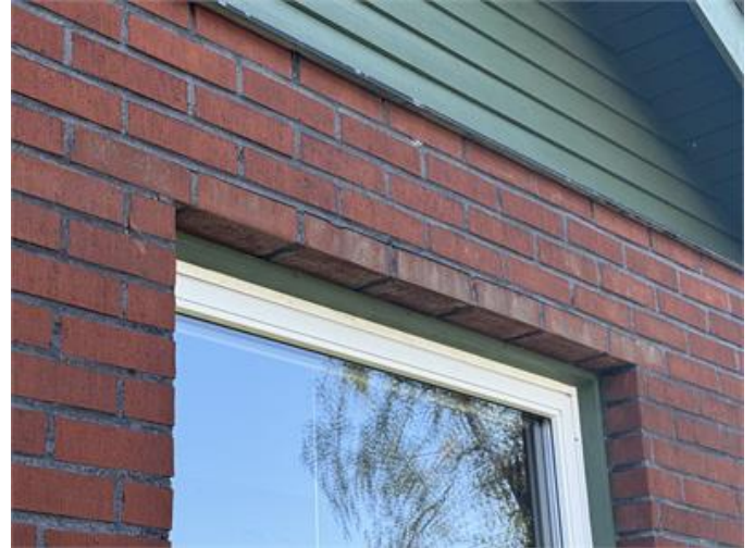
Enstaka sprickor förekommer i tegelfogar.
