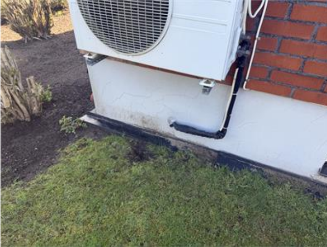
Kondensvattnet leds inte bort från huset.
