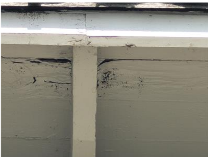
Rötskada i takfot
