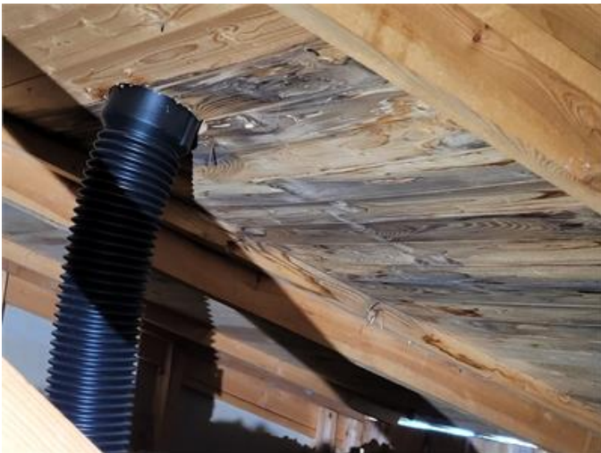
Fukthäcken på underlagstak
