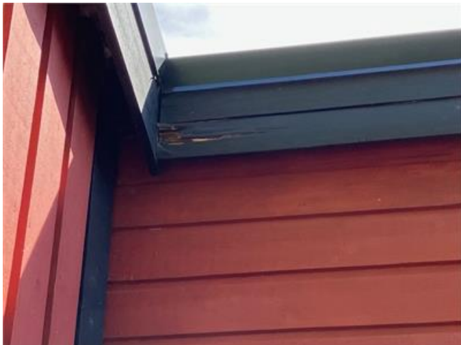
Rötskada i taksarg
