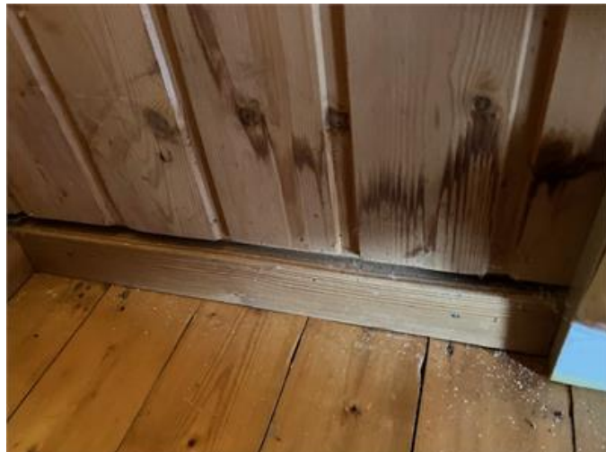
Fuktfläck på vägg
