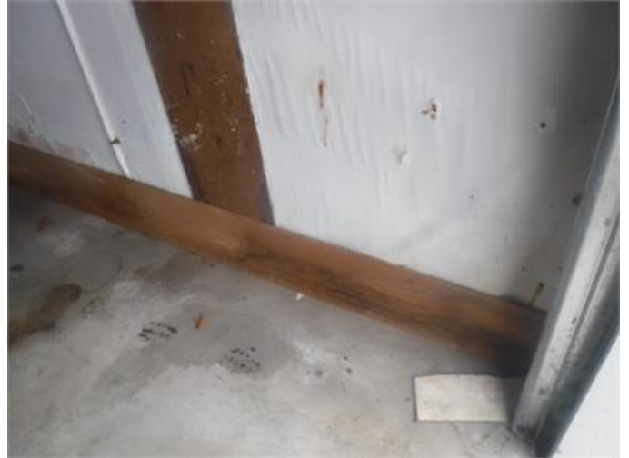
Garage/Invändigt: Puts- och färgsläpp förekommer på nedre delar av murade ytterväggar. Trävägg där det tidigare varit en dörr är fuktpåverkad och hög fukt mättes vid besiktningen.
