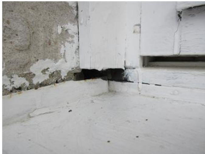
Otät infästning av fönster
