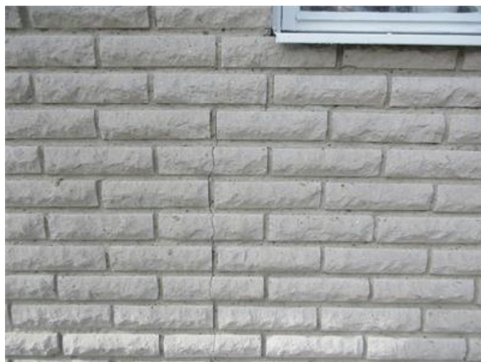
Spricka i fasaden
