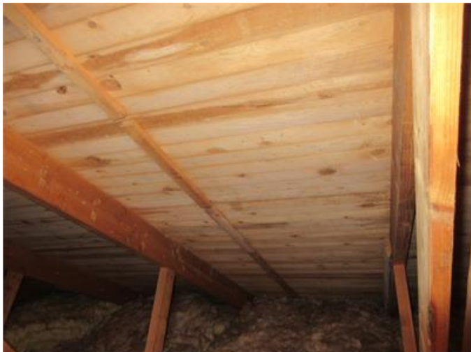
Mikrobiell påväxt på yttertaket
