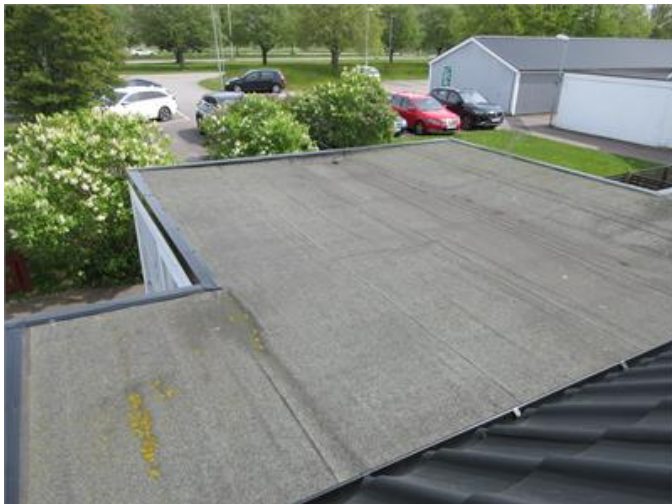
Takpapp på tillbyggd del äldre standard
