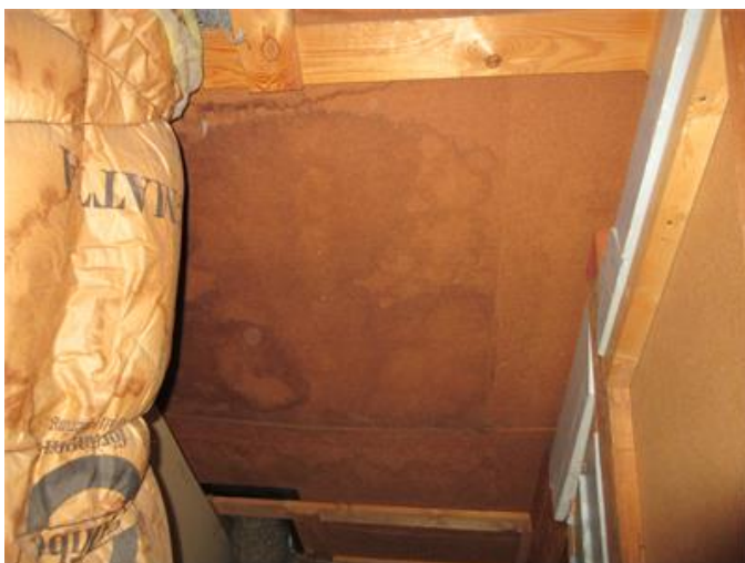
Missfärgning på träfiberskivor i kallvind
