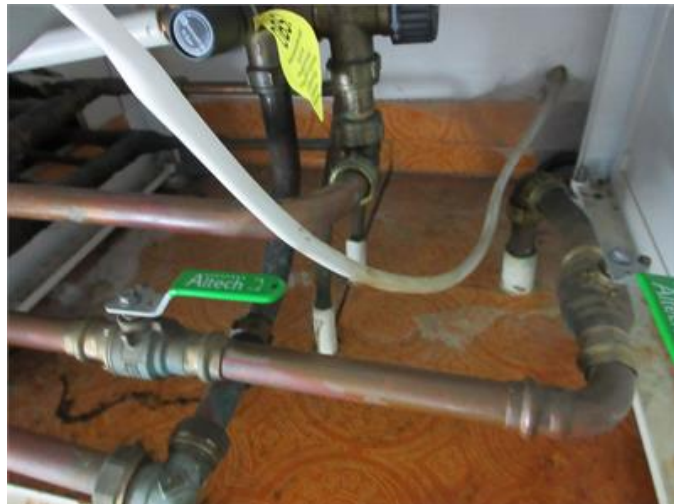
Vatten på golv/beredare i tvättstuga
