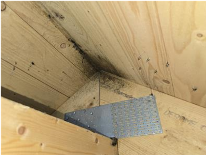
Nockvind: Fläck/missfärgning mot väst, torrt vid besiktning.
