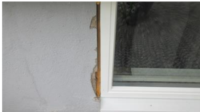
Otättheter i anslutning till fönster.
