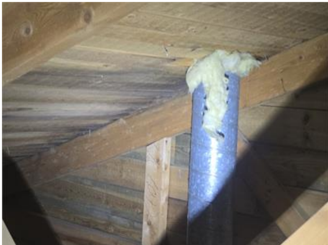
Exempelbild, fuktfläck underlagstak kring genomföring för oisolerat ventilationsrör, köksfläkt.
