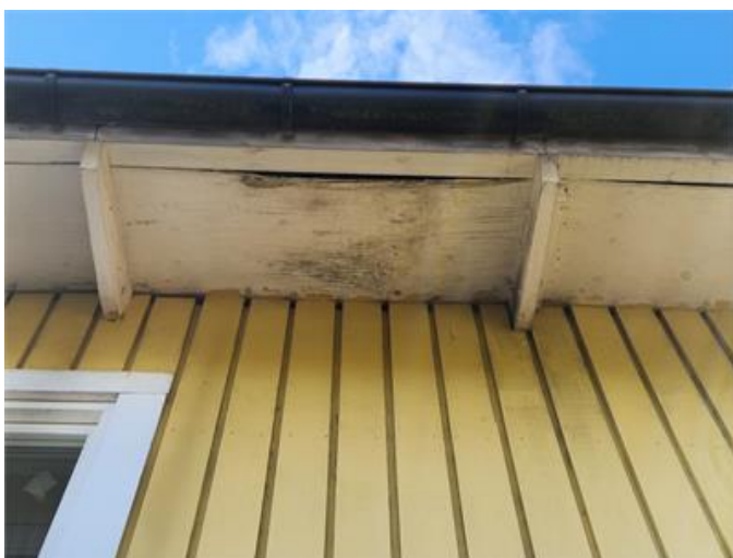
Tak: Fuktgenomslag noterades i takfot.
