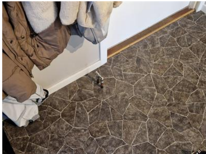
Entréhall: Rör genomföringar placerade på utsatt plats
