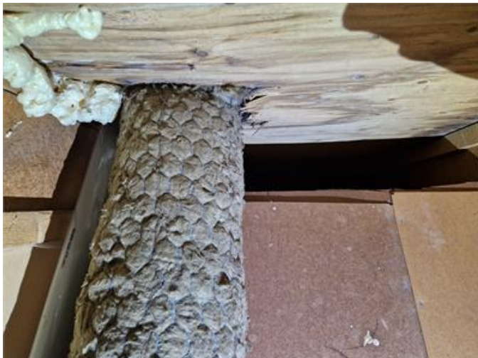
Vind: Fuktfläckar förekommer runt rör genomföring i tak.
