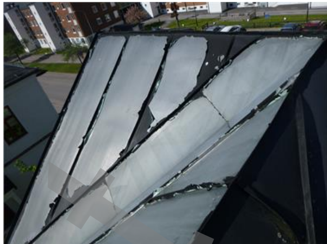
Färgsläpp på yttertak av plåt
