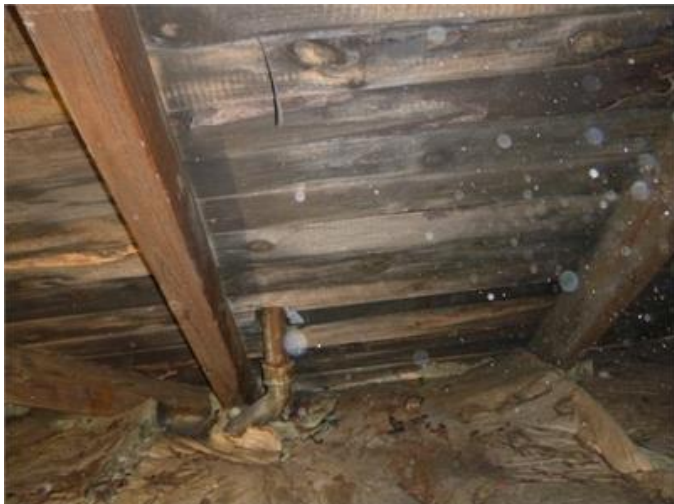
Mikrobiell påväxt på insida yttertak
