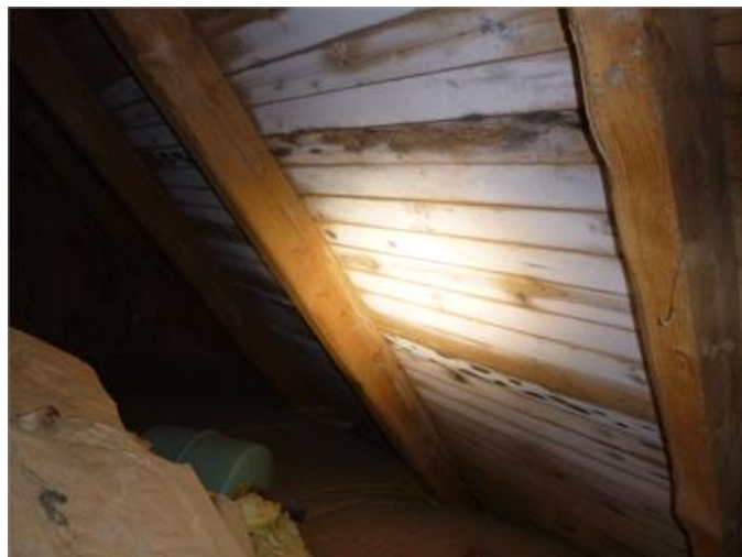
Mikrobiell påväxt på insida yttertak
