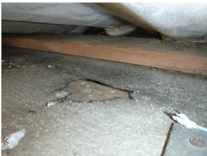
Hål förekommer på underlagstaket av papp
