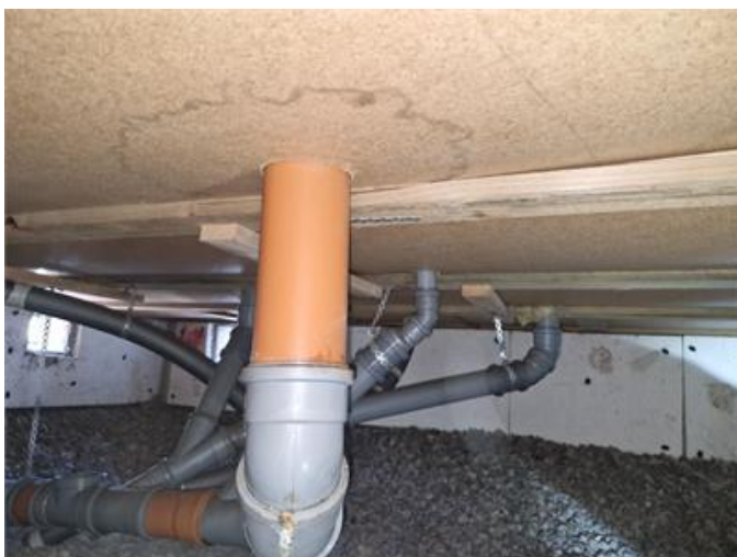
Krypgrund, torr fuktanvisning under WC-stol.
