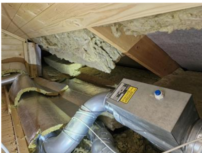
Sidovind väster, diffusionspärr/plastfolie finns ej i den isolerade yttertakskonstruktionen, isolering har delvis ramlat ner.
