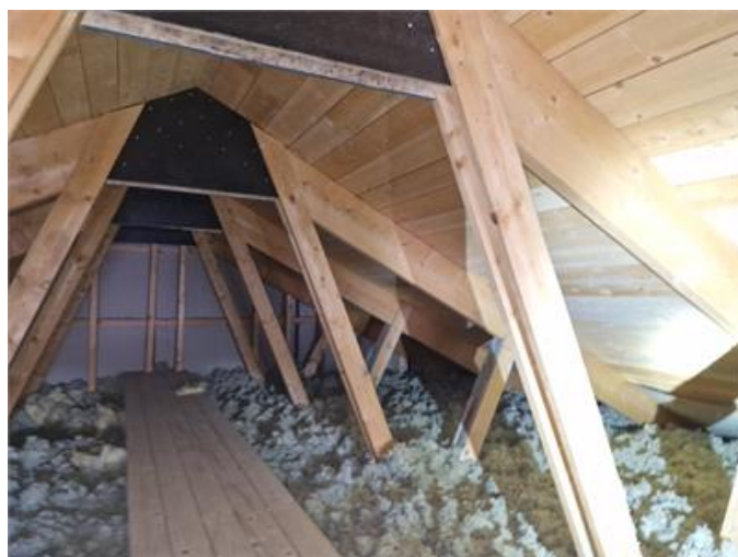
Nockvind öster, översiktsbild, isolerad och otät lucka till utrymmet.
