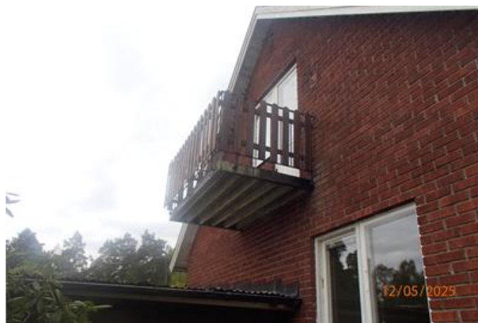
Bild på balkongen. Renoveringsbehov föreligger.
