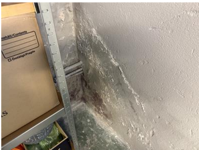
Fuktgenomslag noterades lokalt vid det ena hörnet i källaren.
