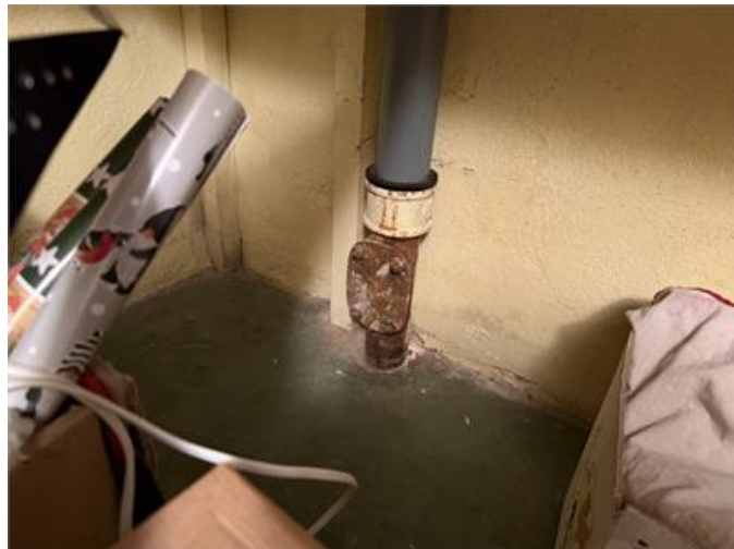
Äldre avloppsrör av gjutjärn förekommer.
