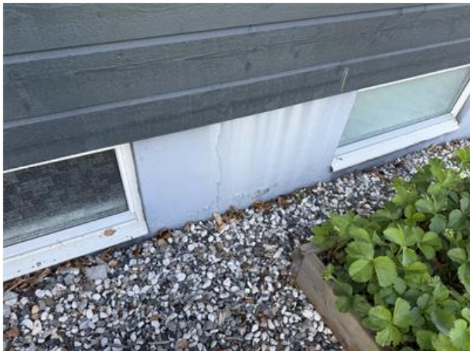
Enstaka sprickor noterades på sockel/grundmur.
