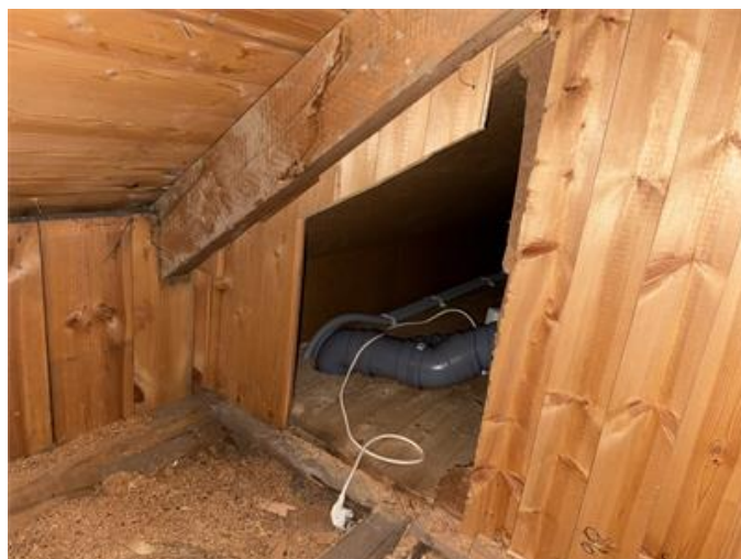
Oisolerade vattenledningar finns i sidovindsutrymme.
