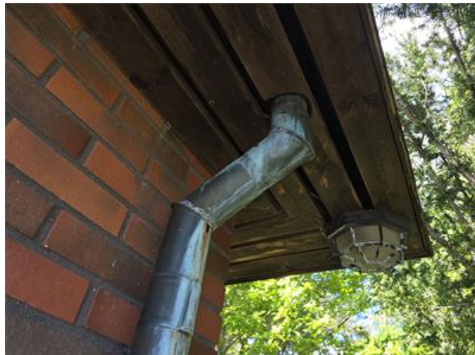
Exempel rosthål i stuprör.
