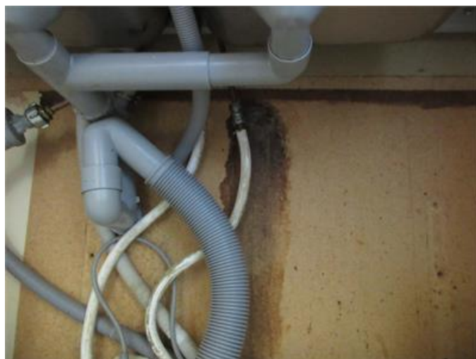
Missfärgningar på bakre vägg i diskbänkskåp
