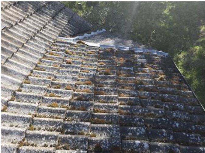
Överblick del av tak, här med mossor och för låg lutning.
