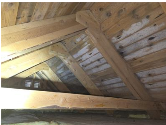
Exempel på mikrobiell påväxt på underlagstak.
