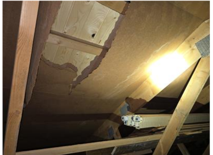
Exempel äldre takbottenskiva som släppt, ovan ses det nya underlagstaket som är av råspont.
