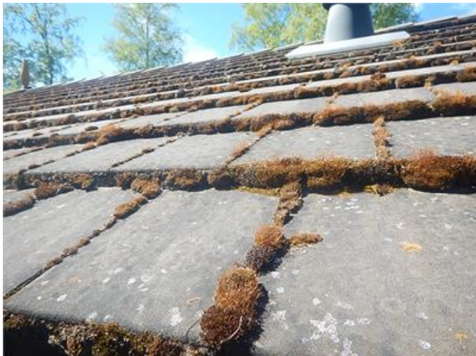
Mossa på takpannor.
