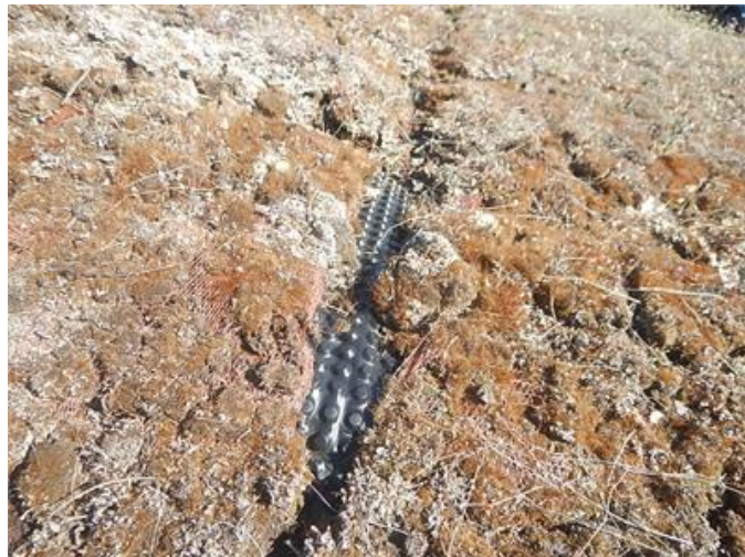
Torvtak som bör kompletteras.
