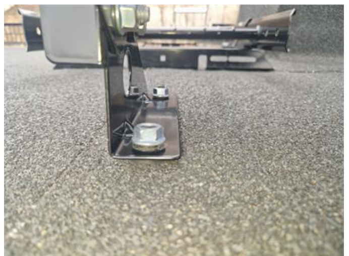
Infästning för takbrygga ej åtdragen
