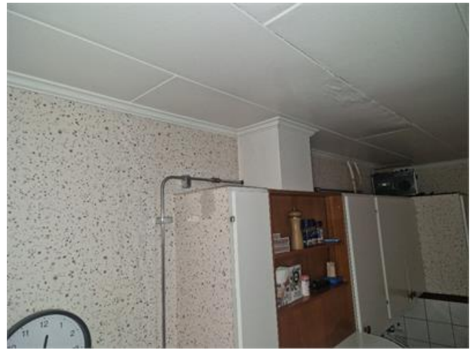
Fuktfläckar i tak.
