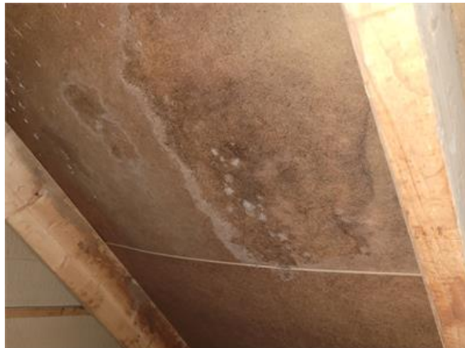
Fuktfläckar på underlagstak
