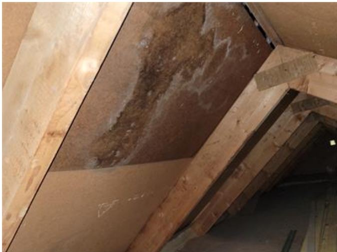
Fuktfläckar på underlagstak
