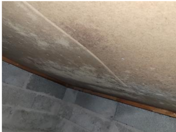
Mikrobiell påväxt på blindbotten.
