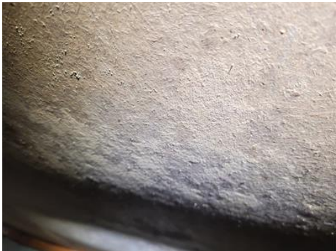
Mikrobiell påväxt på blindbotten.
