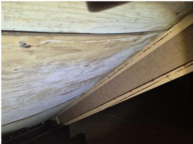
Mikrobiell påväxt på vinden
