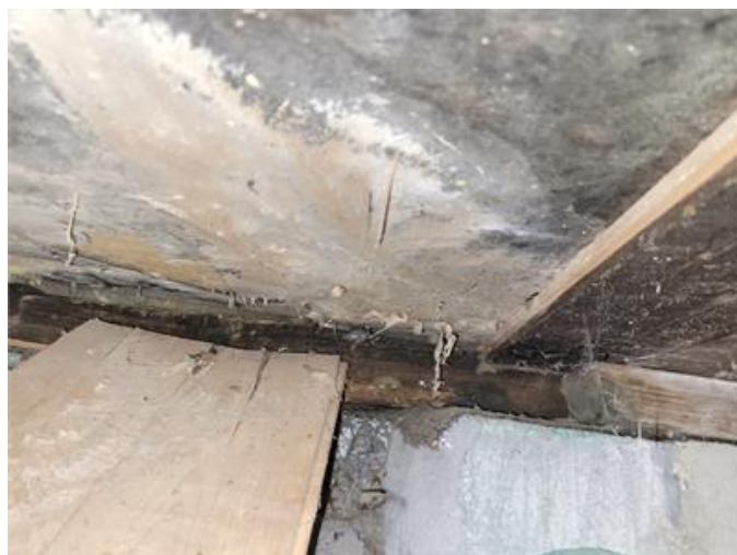
Skador förekommer i golvbjälklaget
