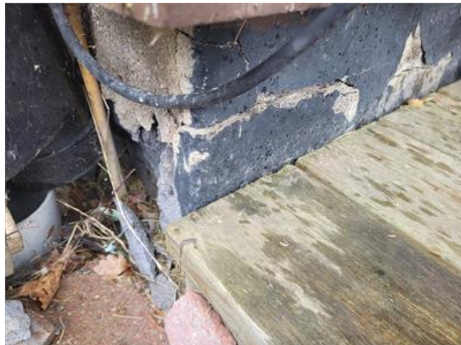
Putssläpp och sprickor på grundmuren
