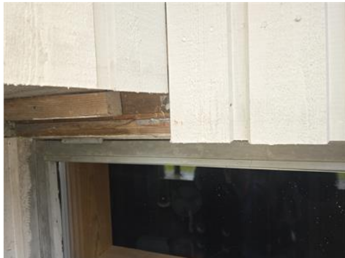
Otätheter i fasaden, underkant av skarv mot burspråk.
