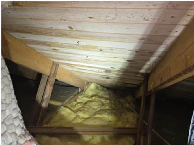
Exempelbild, mikrobiell påväxt vind.
