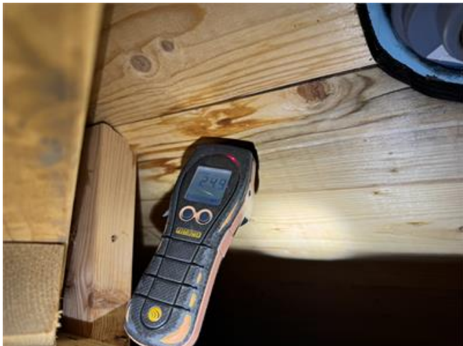
Takläckage vid genomföring.
