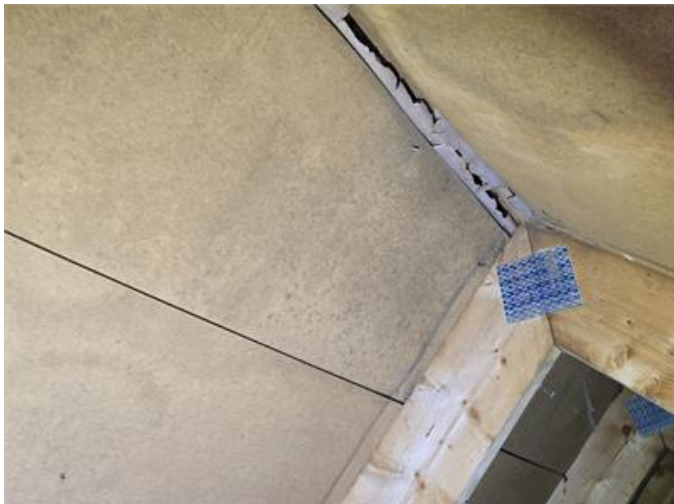
Nockvind: Mikrobiell påväxt/missfärgningar på underlagstak.
