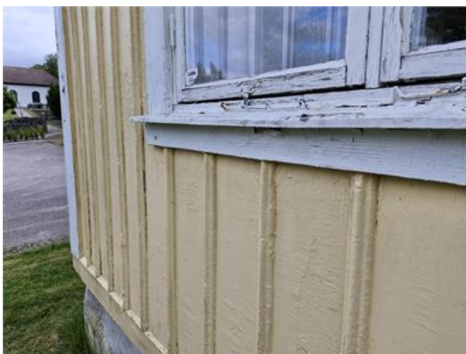
Fasad och Fönster, underhållsbehov och delvis byte.
