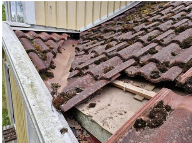
Tak, underlagstak av träfiberskivor ovan omlåttspikade brädor, delvis moss på pannorna.
