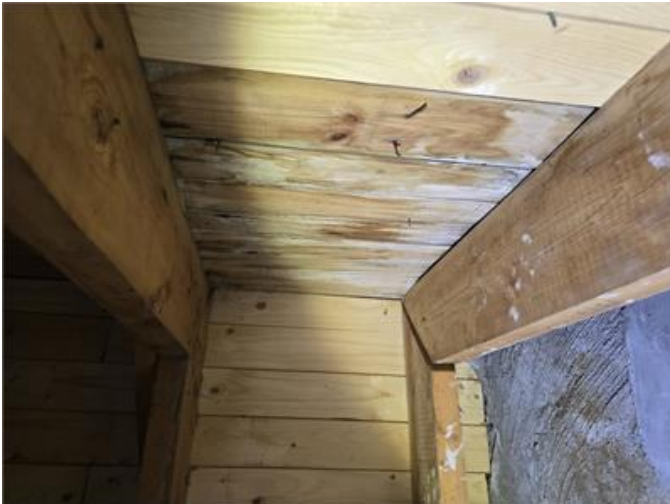
Nockvind: Mikrobiell påväxt/missfärgningar runt murstock.
