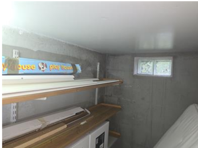
Exempel på missfärgningar/påväxt på vägg i källare.
