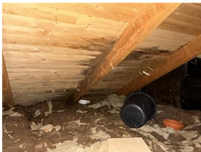
Mitten Nockvind: Fuktanvisning på underlagstak.(torr vid besiktning).
