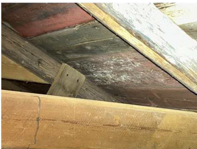
Norra Nockvinden: Påväxt samt fuktskadat underlagstak.
