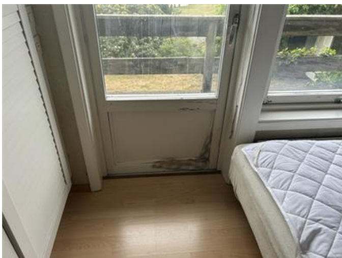
Sovrum 1: Altandörr fuktskadad.
