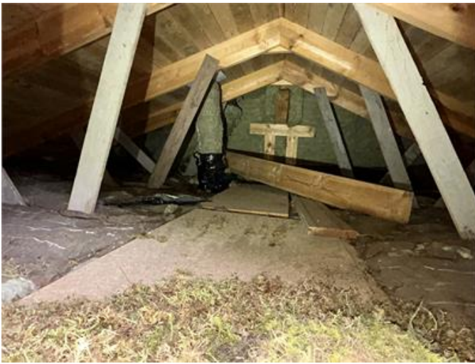
Södra nockvinden: Mikrobiell lukt samt fågelbo.
